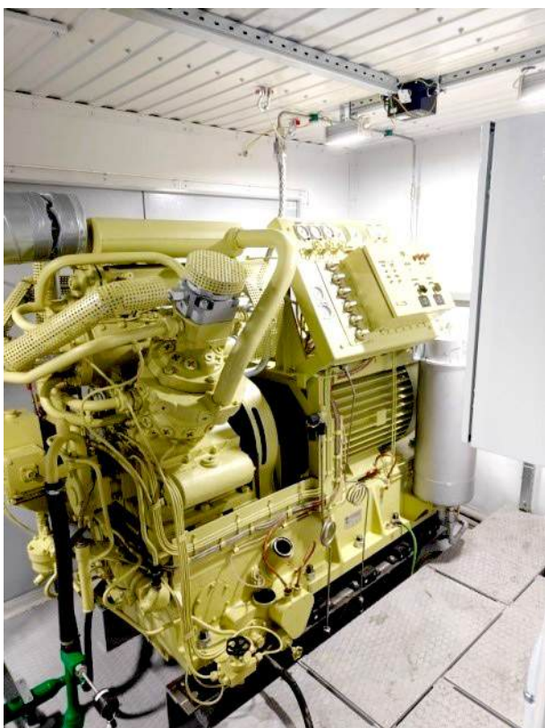
Рис. 2. Компрессорная станция ЭКСА7,5-3М-1 Fig. 2. EKSA7.5-3M-1 compressor station
