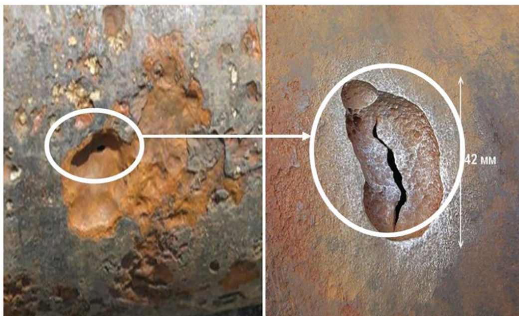
Рис. 2. Трещиноподобные дефекты МТ коррозионного происхождения
