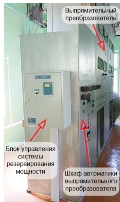
Рис. 4. Внешний вид блока управления системы резервирования мощности на тяговой подстанции
