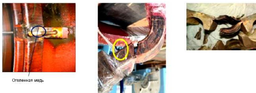
Рис. 7. Варианты дефектов шин: а — первый вариант — повреждение изоляции шин в креплении шинодержателя с истиранием изоляции (до меди); б — второй вариант — механическое разрушение выводной шины к линейному трансформатору ф. В, ТВВ-800. Диагностический признак — критический рост виброперемещений на частоте 100 Гц, разрядные процессы отсутствовали; в — третий вариант — повреждение гибкой перемычки 1С1 из-за растрескивания металла и металлического разрушения металла от вибрации и возникновения дуги в зонах разрыва
