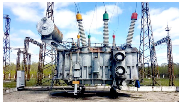
Рис. 1. Внешний вид автотрансформатора АТДЦТН-63000/220
