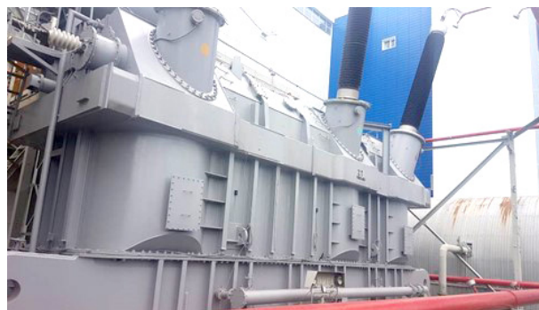
Рис. 5. Внешний вид трансформатора со стороны ВН
