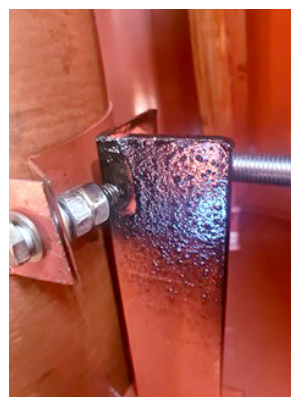
Рис. 4. Вероятное место дефекта (т. 24, 25, 26)
